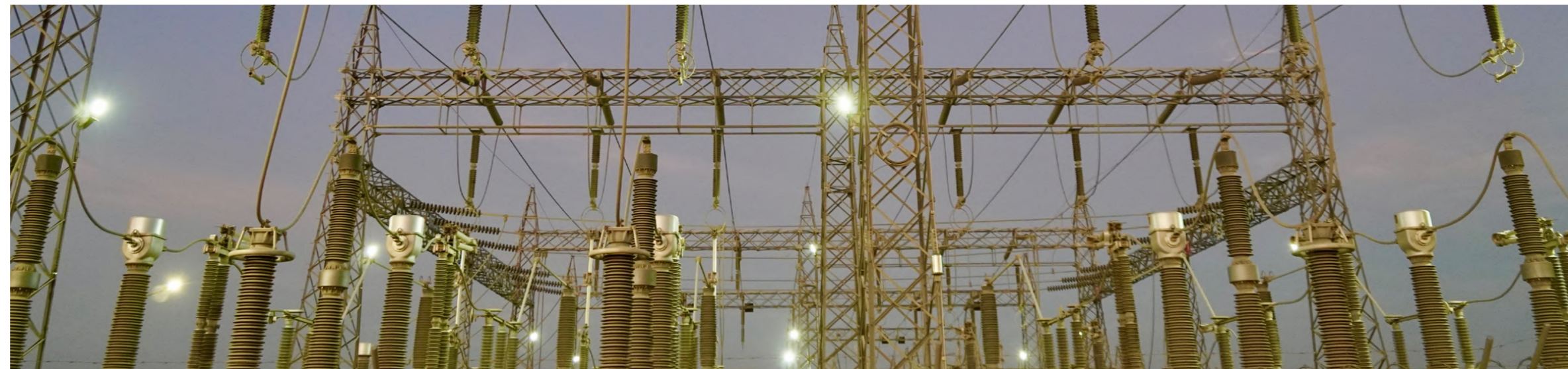
Substation Valle del Chira, Peru.
