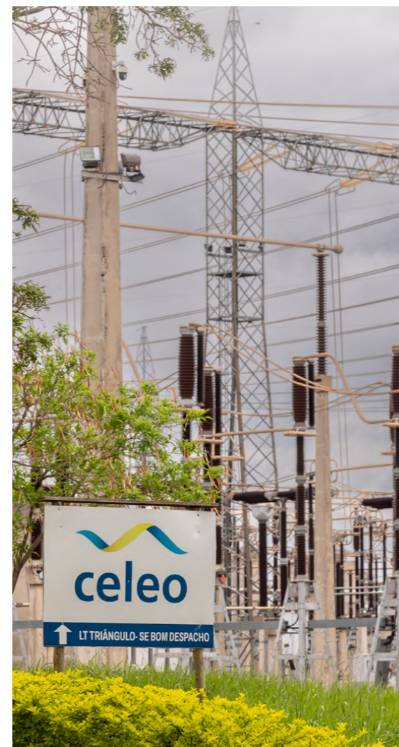
Entrada de la subestación Bom Despacho, línea de transmisión Triângulo, Brasil.
