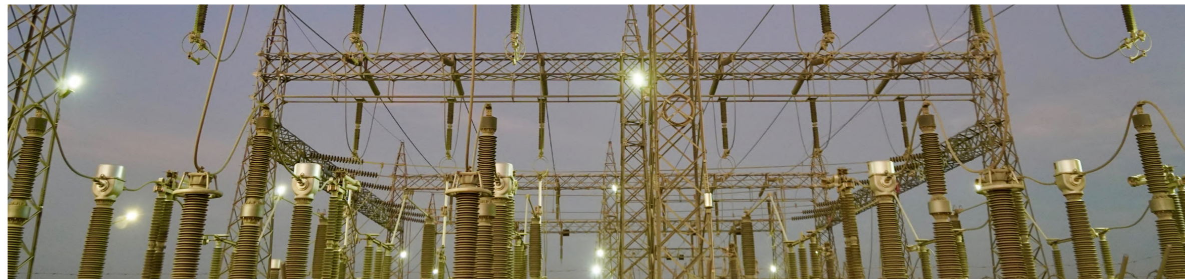
Susestación Valle del Chira, Perú.
