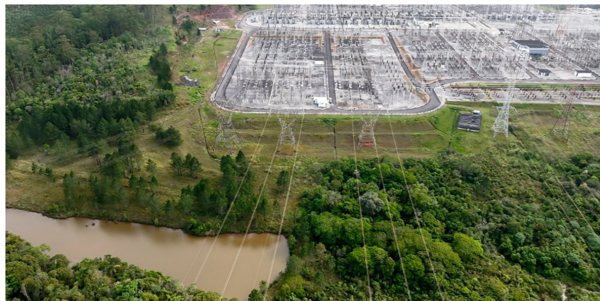
Subestación Tijuco Preto, instalación de la línea de transmisión Cachoeira Paulista, Brasil.
