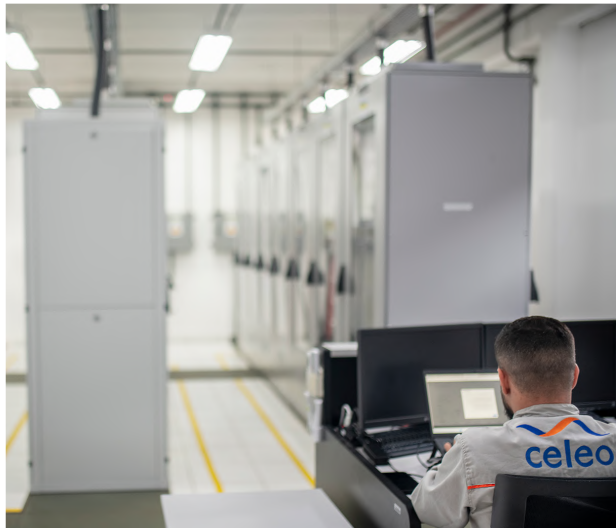
Trabajador de Celeo en la subestación Fernão Dias, de la línea de transmisión Cantareira, Brasil.
