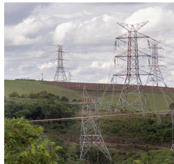
Línea de transmisión Cantareira, Brasil.
