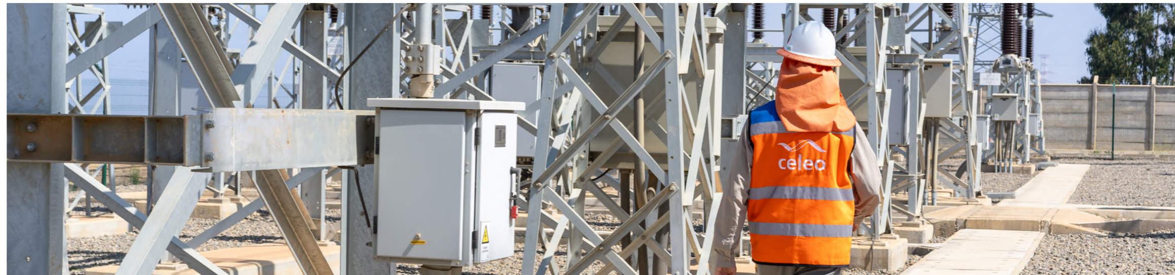
Trabajador de Celeo en la subestación La Pólvara, Chile.
