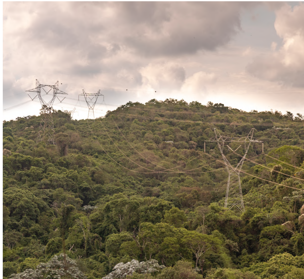
Línea de transmisión Cantareira, Brasil.
