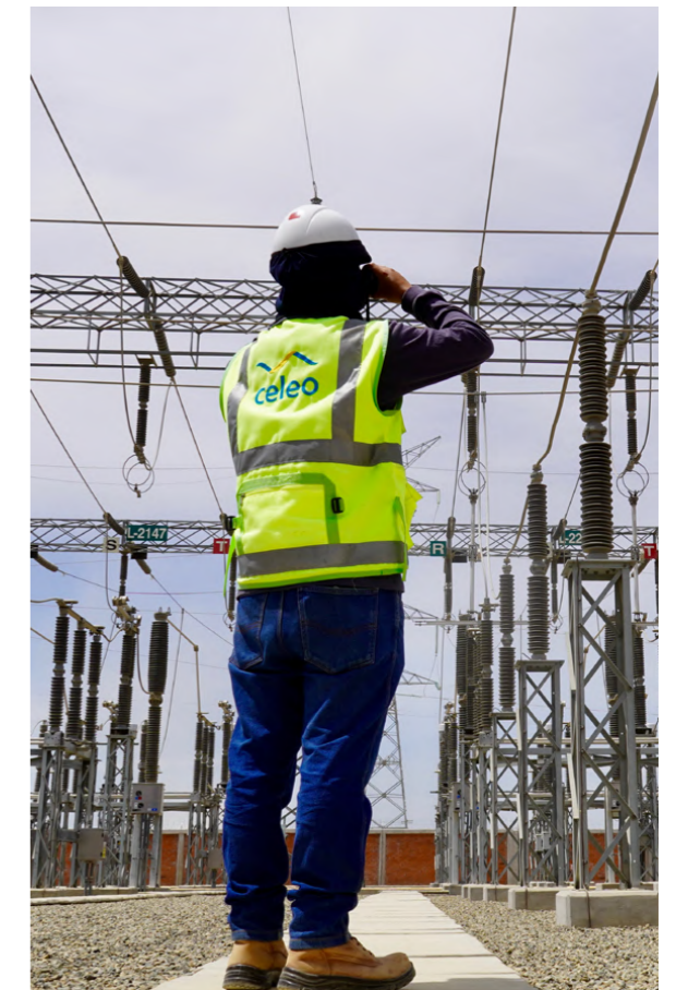
Trabajador de Celeo en la subestación de Valle del Chira, Perú.
