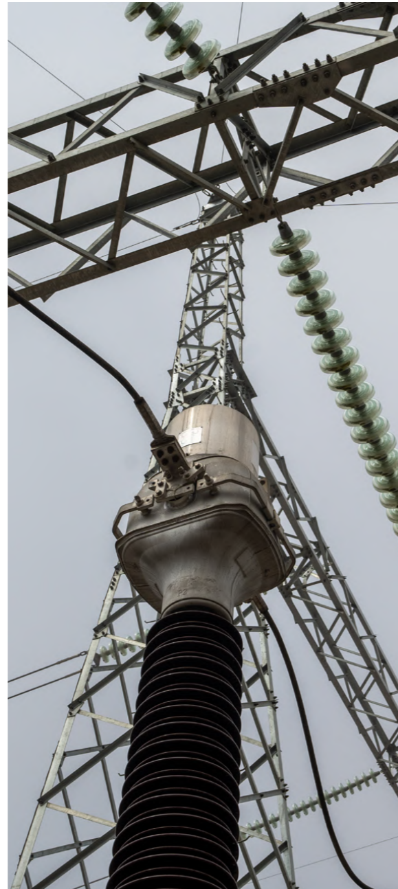
Línea de transmisión La Pólvora (CASTE), Chile.
