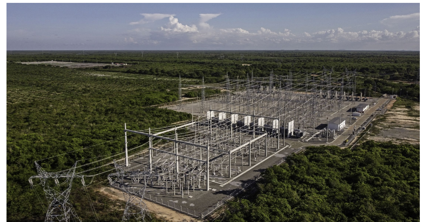
Subestación Acaraú III, SITE
