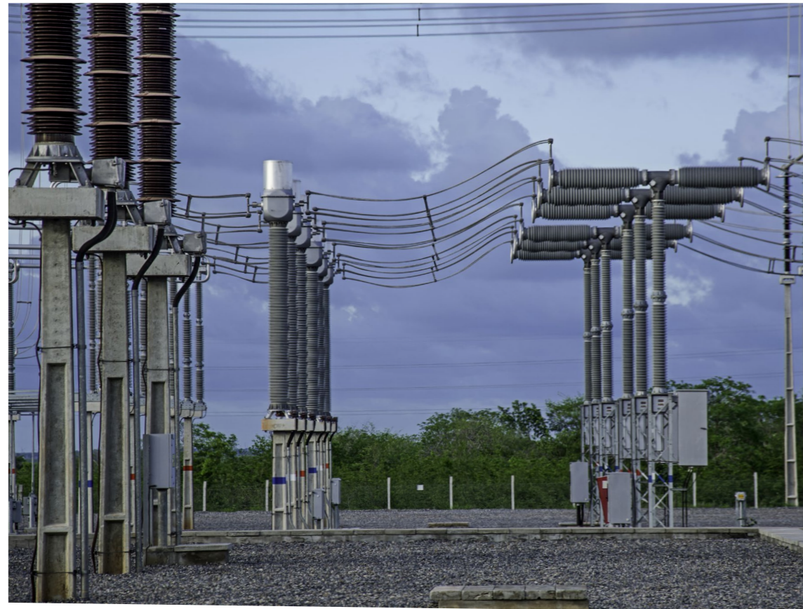
Subestación Parnaíba, SITE
