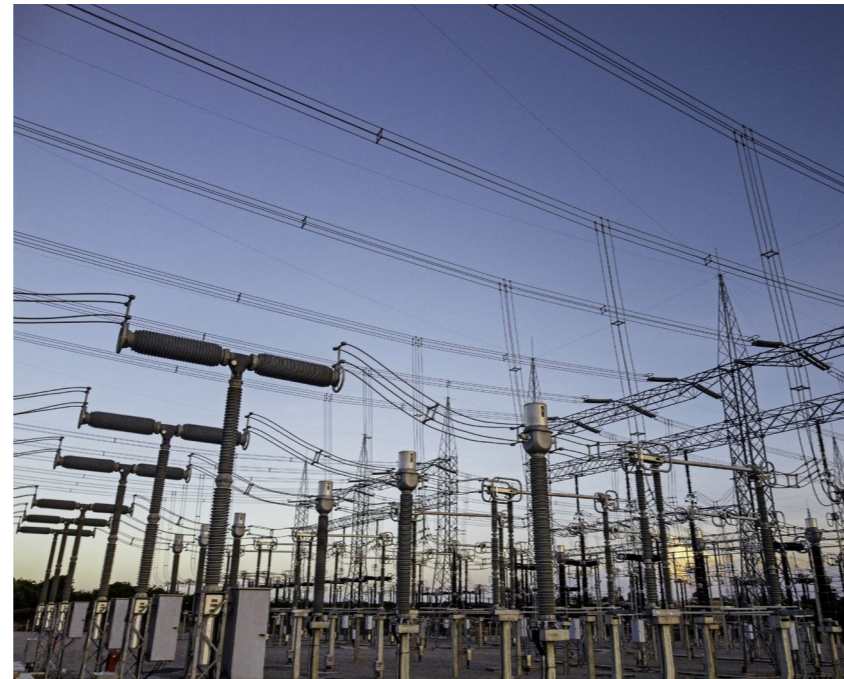
Subestación Acaraú III, SITE
