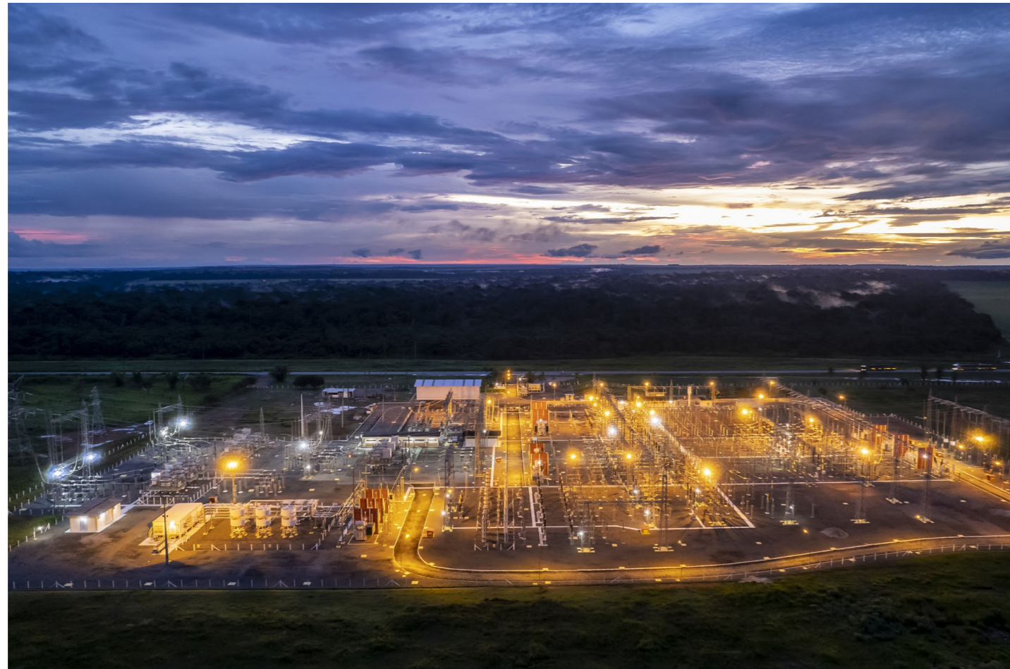
Subestación Vilhena, JTE
