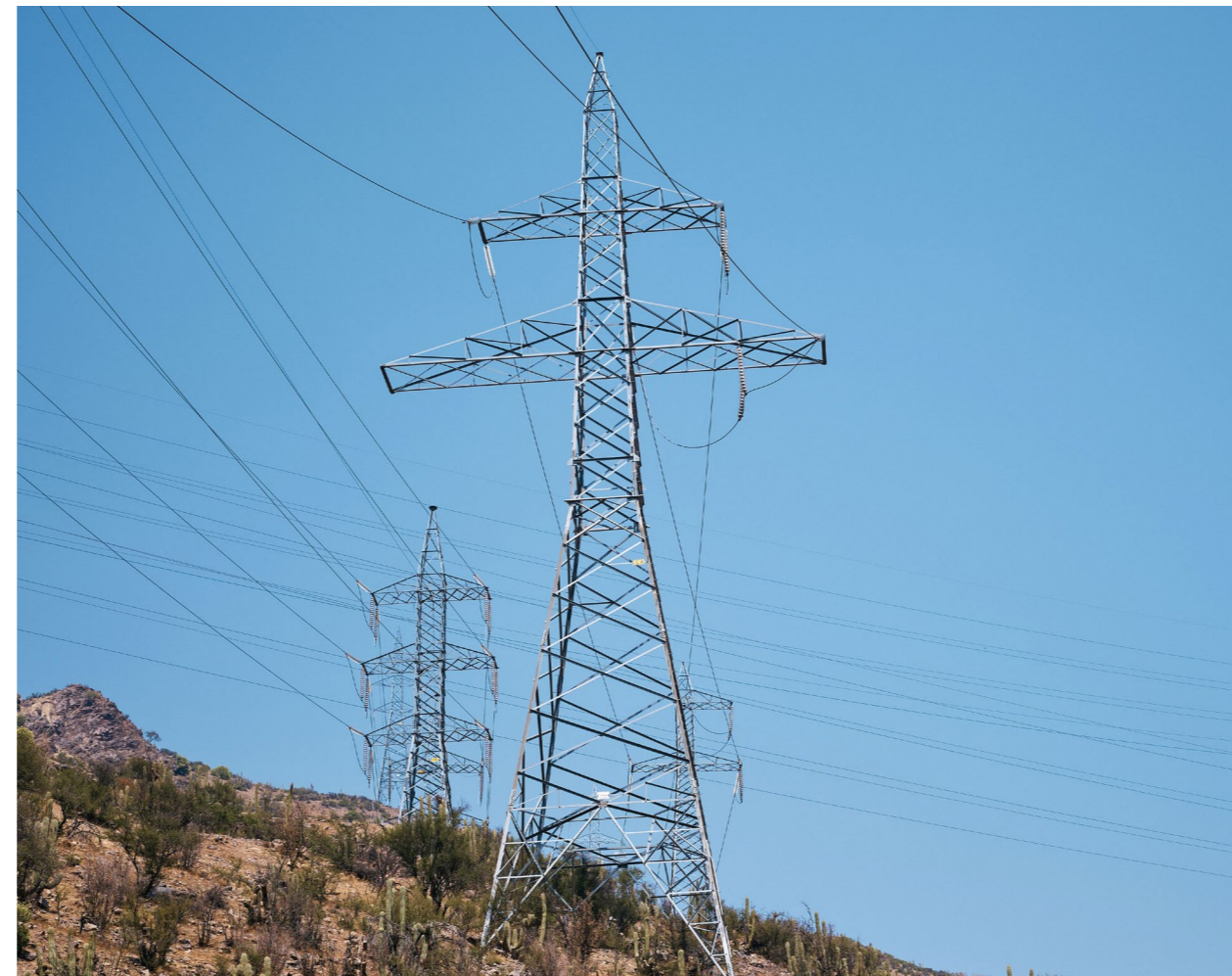
Subestación Los Maquis, Zona Aconcagua
