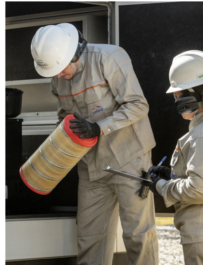
Equipo de EAT realizando mantenimiento preventivo en equipo de la subestación Vilhena, JTE
