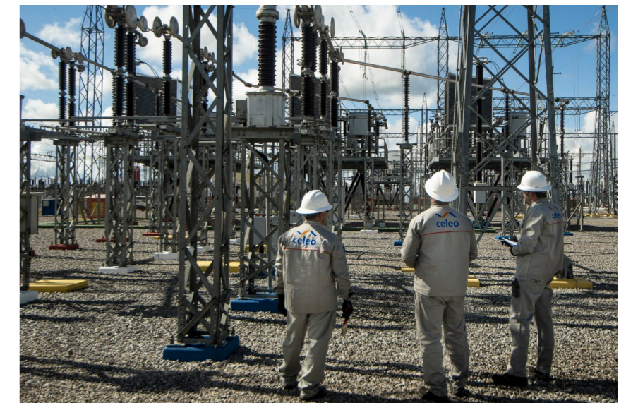
Equipo de EAT realizando inspección en equipo de la subestación Vilhena, JTE
