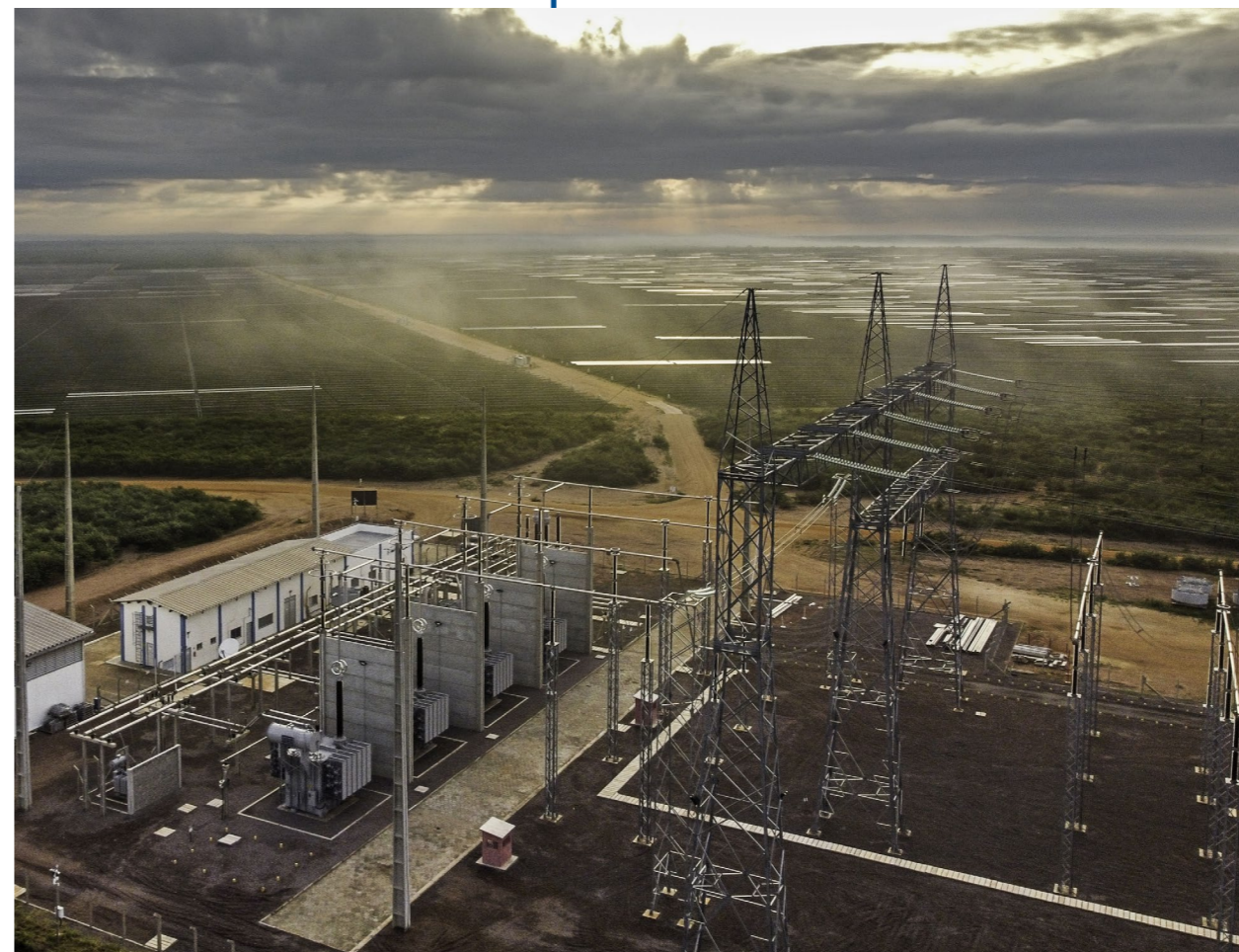
Subestación Coletora São João do Piauí, UFV-SJP
