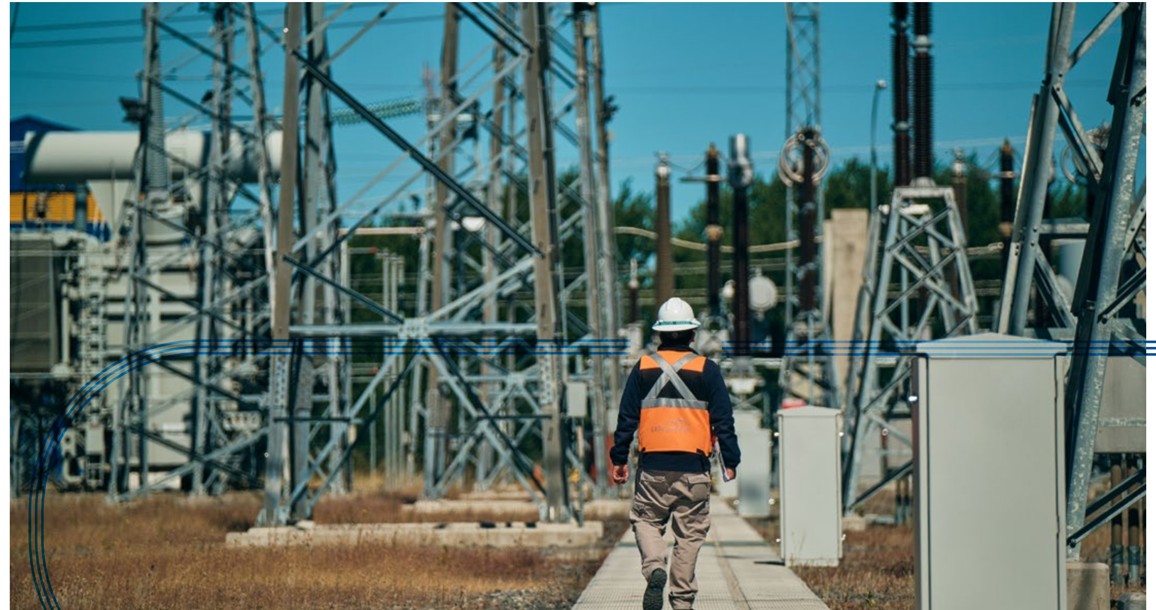
SUBESTACIÓN CHARRÚA (CHILE)
